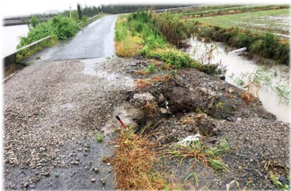
7月豪雨での溢水による道路崩壊
