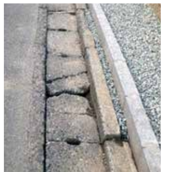
側溝のふたの破損
