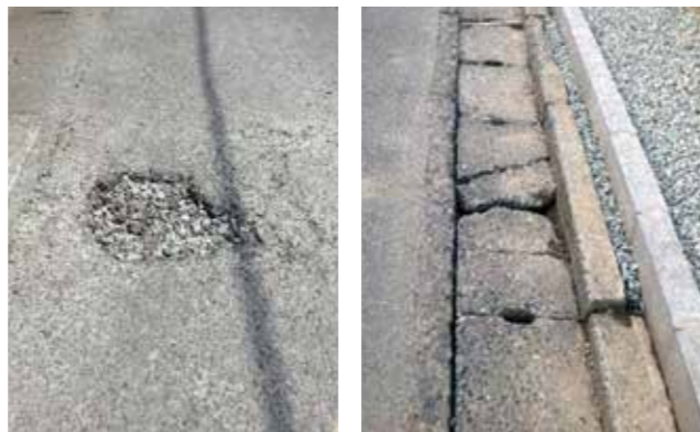
【左】道路上にできた穴ぼこ 【右】側溝のふたの破損
