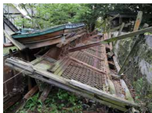
平成28年の熊本地震では三柱神社本殿南側にある文政9（1826）年建築の木塀が倒壊
