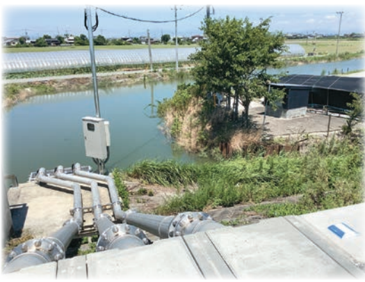
大型水中ポンプ設置状況(加受樋管横)
