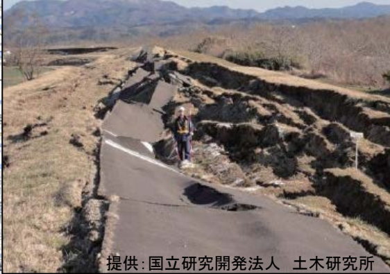
東日本大震災で被害を受けた河川堤防
