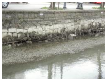
■ 石積護岸の抜け落ち
