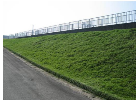
緑化することで法面を修景しています（他都市の例）
