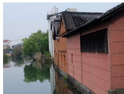
図 4-9 並倉西外壁面の歪み
