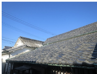
図 4-3 主屋 屋根瓦の劣化
