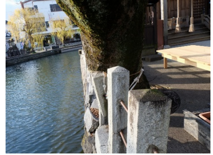
図 4-10 護岸をき損しているエノキ
