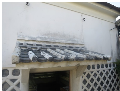
図 4-4 穀倉 庇の劣化
