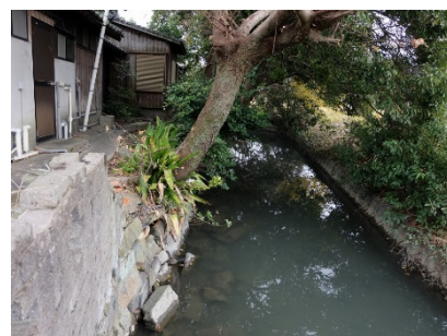
図 4-2 護岸をき損させている樹木
