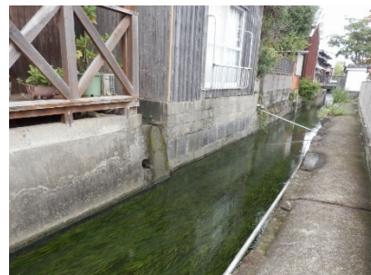
図 4-1 水草の繁茂による 水流の阻害
