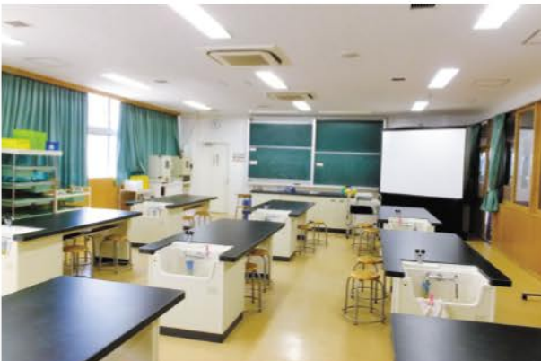
中学校特別教室空調設備
