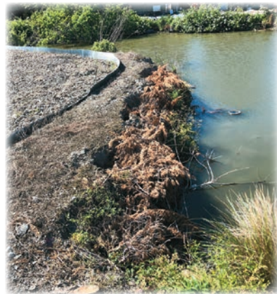
蒲池地区 入込水路護岸崩れ
