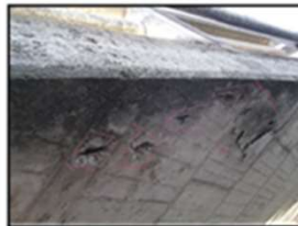
措置が必要な状態
