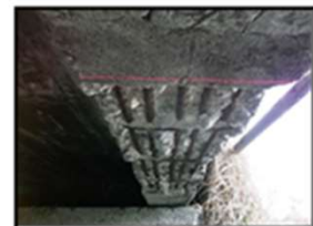
緊急措置が必要な状態
