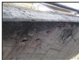
措置が必要な状態
