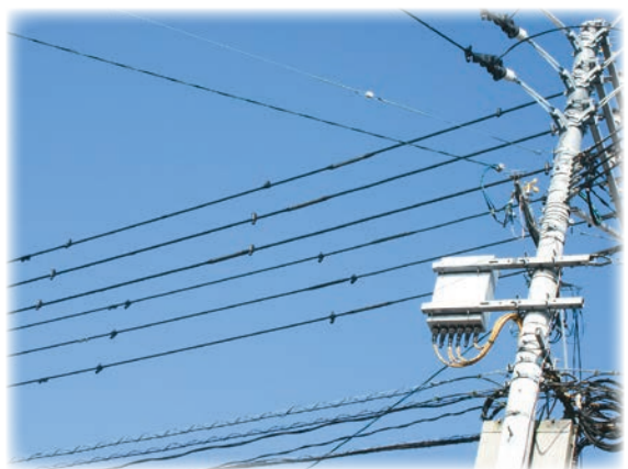
京町交差点付近の電線
